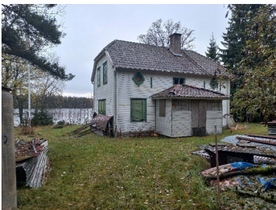
Äldre fritidshus, ca 1920-tal med bevarad karaktär, men har stort behov av underhåll. (2023-11-01)
