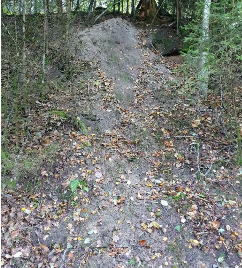
Figur 64. Foto med vy söderut på möjligtvis ett trögt pågående skred. Det kan även vara ett bo för djur eller insekter.
