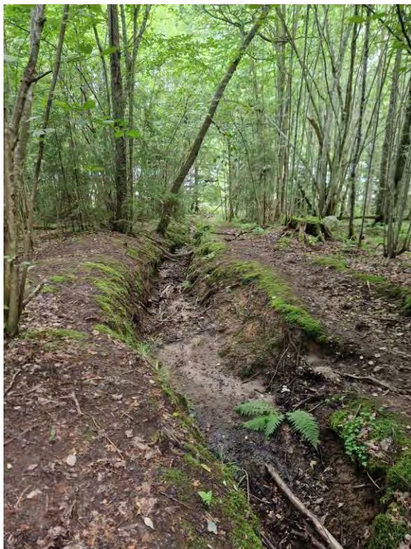
Figur 60. Foto med vy norrut på dike med erosionsskador, söder om avloppsreningsverket.
