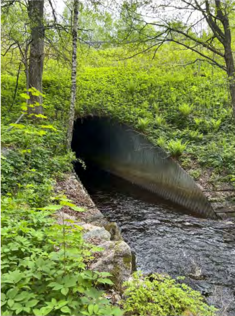
Figur 2 Uppströms inlopp till trumman under Hjälvägen (Foto: Bobecks Bygg &amp; Konsult AB, 2021).
