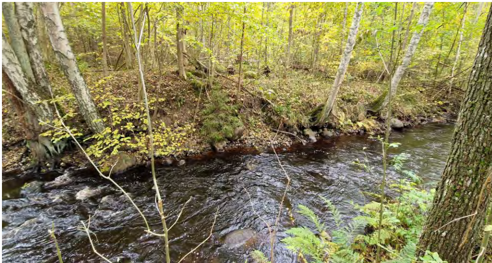
Figur 36: Foto av slänt mot ån, där slänten i fotot är på åns norra sida. Notera följande i bilden: att det finns naturliga "erosionskydd" i åfåran i form av sten och block, två mindre partier i mitten på fotot där slänten har rasat in mot ån och de träd till vänster och höger i fotot som har förstärkt slänten som är nu underminerad.
