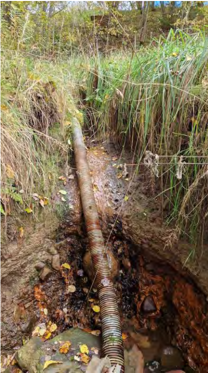
Figur 25. Foton på dräneringsrör direkt öster om industrin, där det pågår erosion.
