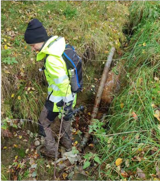
Figur 24. Foton på dräneringsrör direkt öster om industrin, där det pågår erosion.
