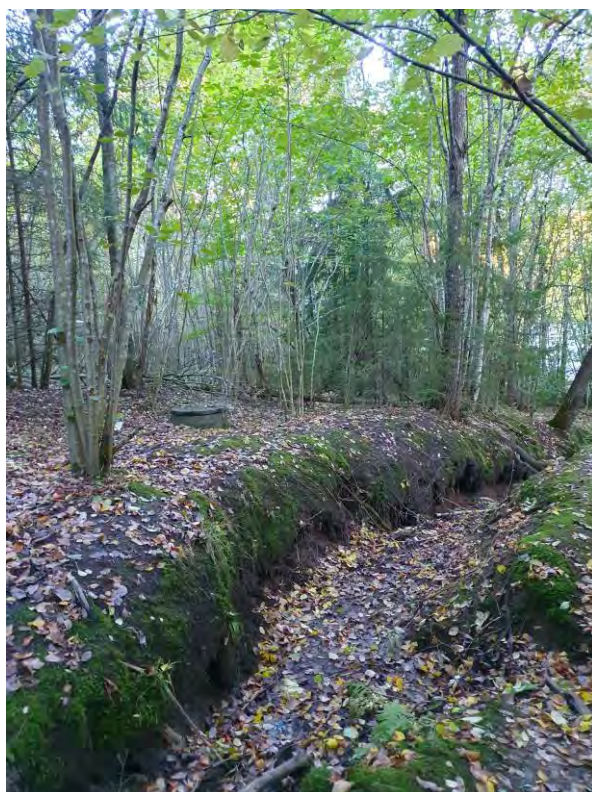
Figur 61. Foto med vy norrut på dike med erosionsskador, söder om avloppsreningsverket.
