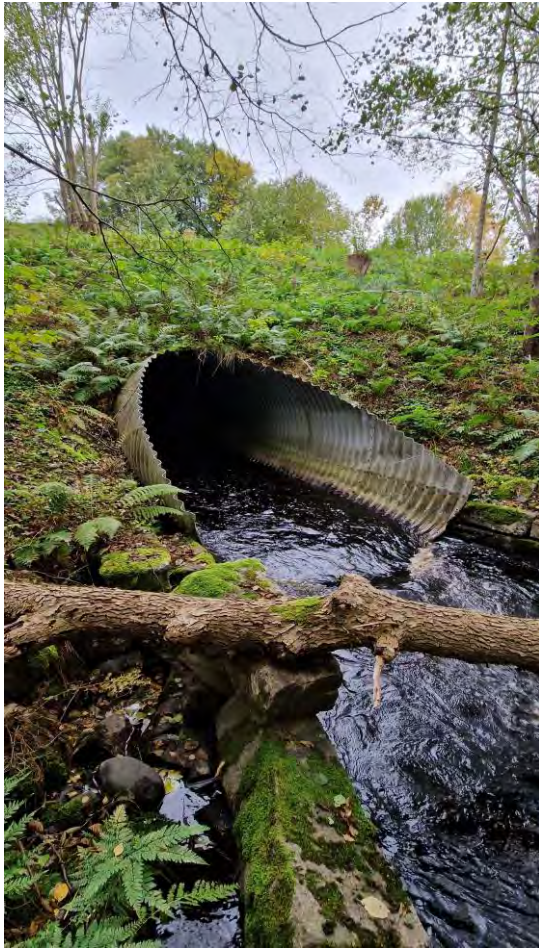
Figur 18. Foto på trumman nedstöms, på Hjövågens östra sida, där erosionen under trumman delvis är synlig.
