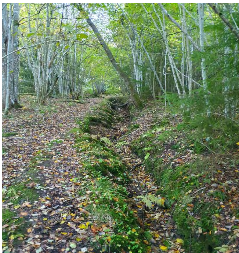
Figur 59. Foto med vy söderut på dike med erosionsskador, söder om avloppsreningsverket.
